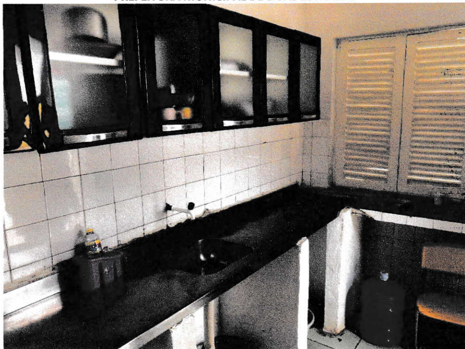
Foto 8 – Interior da cozinha. Será removida a esquadria de madeira e colocada uma esquadria de alumínio com vdras. As cerâmicas danificadas serão substituídas. Será colocado um sifão sob a pia. A torneira de plástico será trocada por uma cromada.
